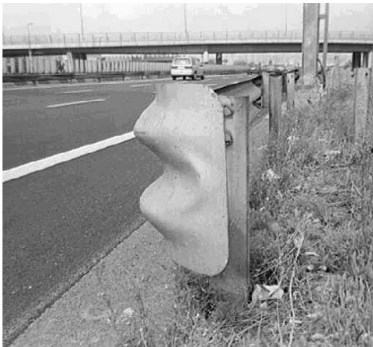
Fig. 71 Terminale di barriera di uso corrente ed elevata pericolosità.
