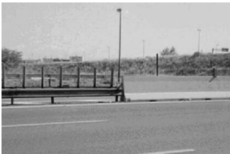
Fig. 72 Esempio di completa mancanza di transizione tra barriera flessibile e rigida.
