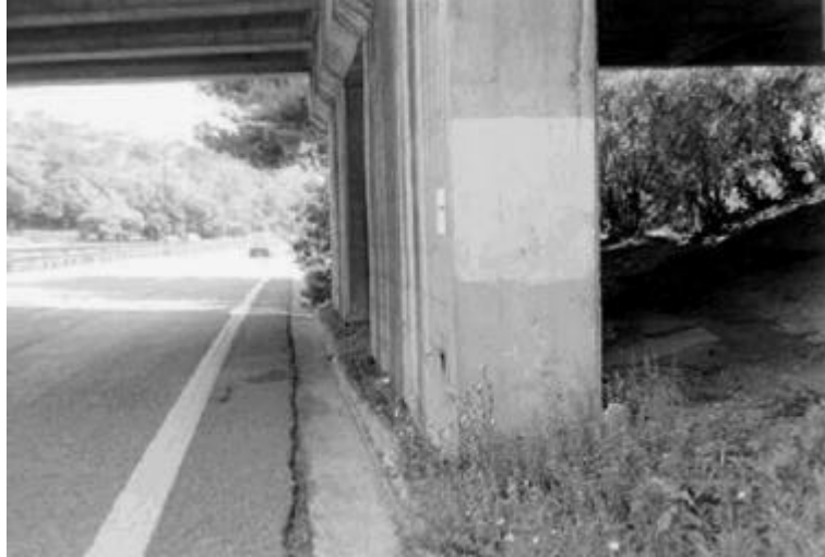
Fig. 69 Esempio di Pila di un viadotto non protetta.
